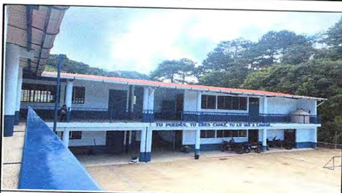
Foto 3: Estado actual de la pintura del establecimiento.
