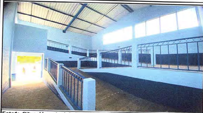
Foto1: Situación actual de la pintura exterior del ingreso al segundo nivel del establecimiento
